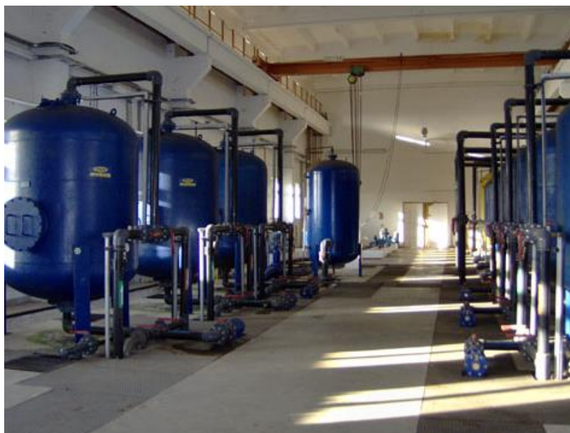
Stacja wodociągów w Drzewicy Źródło: UM w Drzewicy
