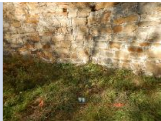
Szkic 25 Odkrywka 11 w południowo wschodnim narożniku ściany w styku z wieżą, lokalizacja odkrywki i zarysowanie w styku ścian
