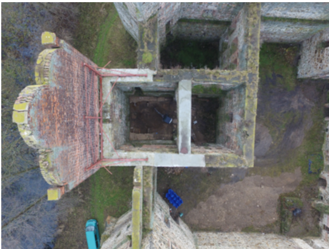
Szkic 48 Górne krawędzie kamiennych ścian przy attyce i awaryjne podparcie murowanej attyki
